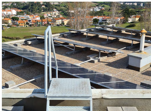
/ Painéis fotovoltaicos no telhado da AstraZeneca em Portugal
