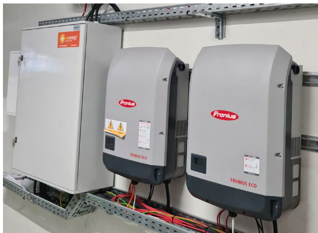
/ 5 inversores Fronius instalados para a conversão de energia solar em eletricidade
